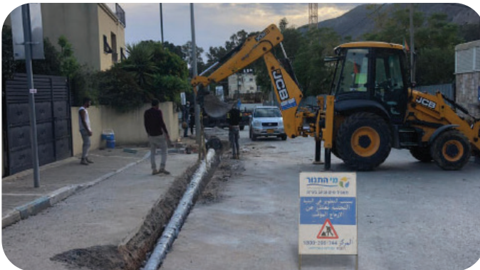
أعمال لتحسين البنية التحتية لمياه الشرب في شارع ترومبيلدور في كريات شمونة
